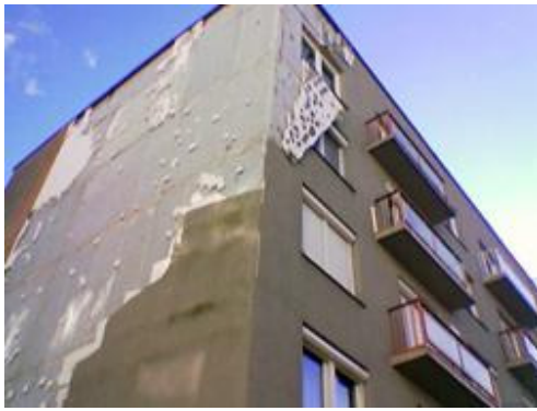
Előbb a hőszigetelés leválása, ..... dűbelezés.
